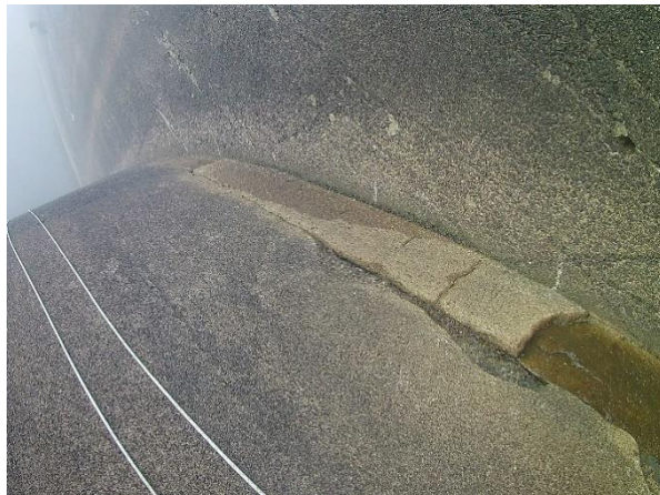
Estado de las juntas en los vertederos
